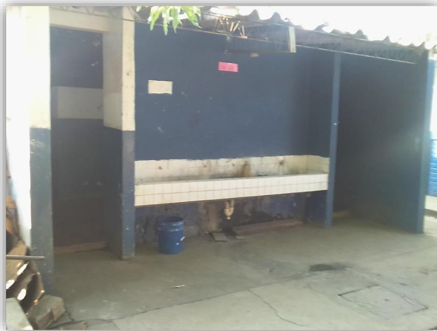
Fotografía N15: Servicios sanitarios en mal estado. Fuente: Fotografía tomada por grupo de trabajo.
