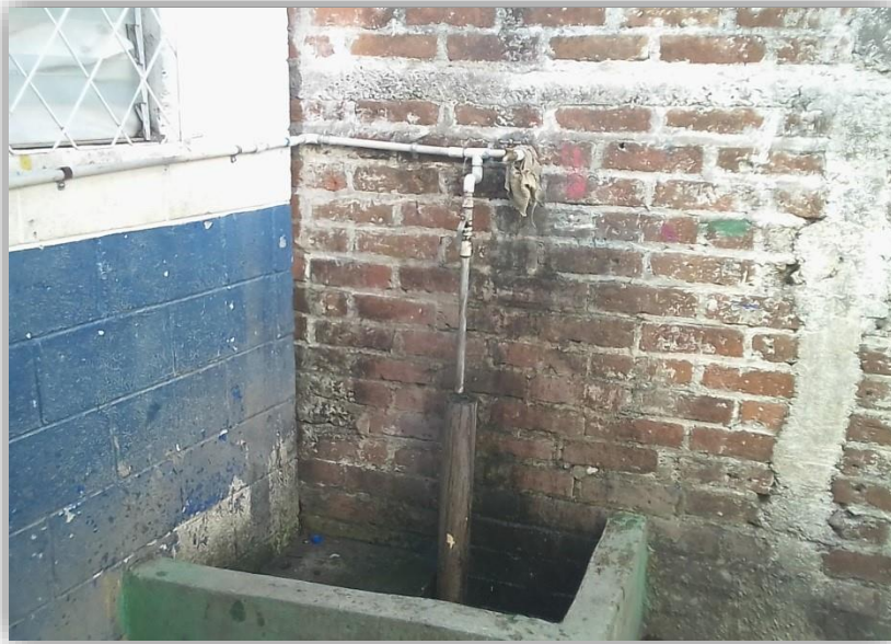
Fotografía N12: Bebedero en mal estado, área de educación media. Fuente: Fotografía tomada por grupo de trabajo.
