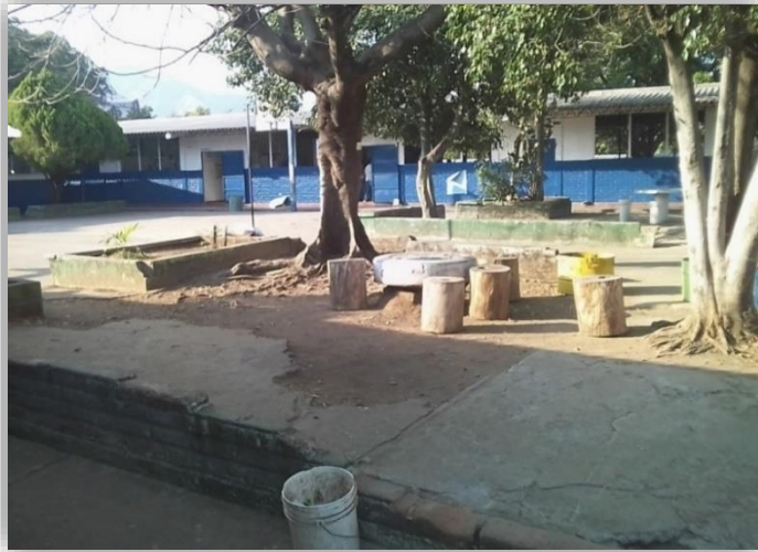
Fotografía N6: Espacio para esparcimiento en mal estado. Fuente: Fotografía tomada por grupo de trabajo.
