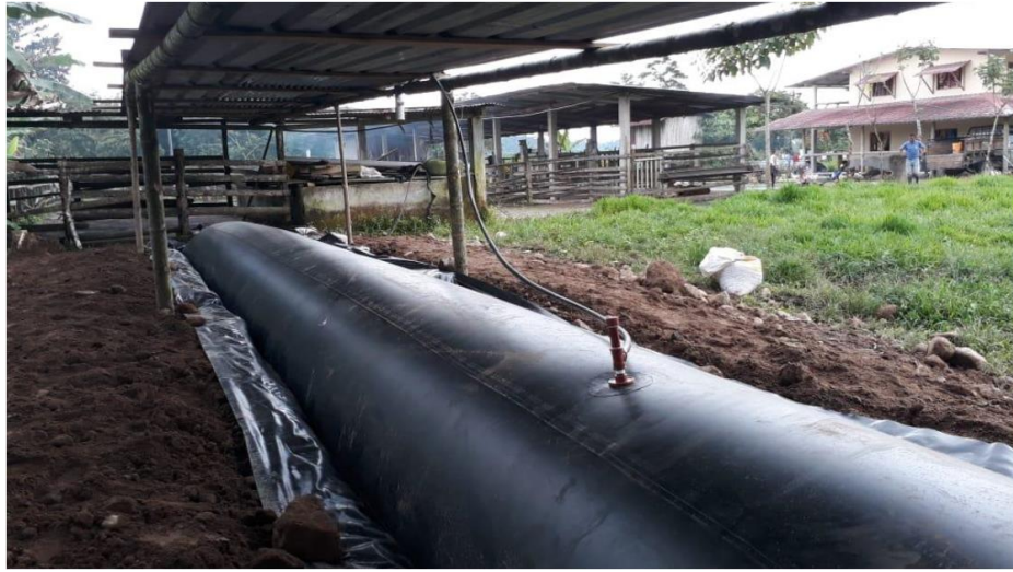
Figura 23 Sistema de conducción y filtrado de biogás
