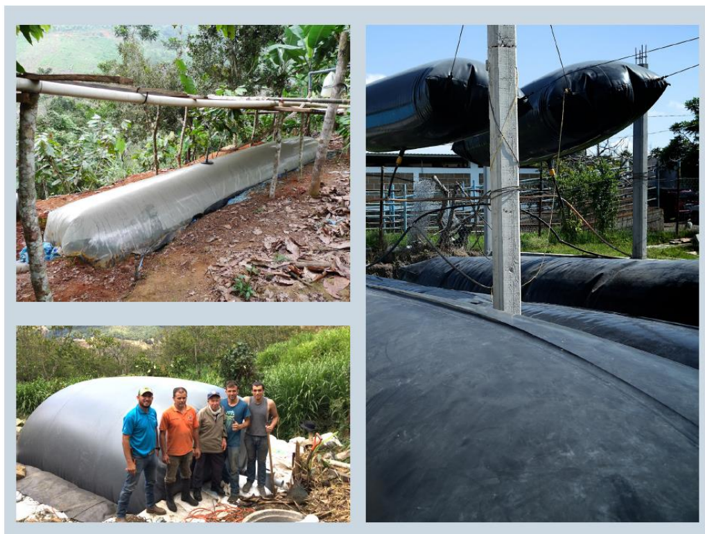
Figura 20 Biodigestores tubulares de plástico (Ecuador) (arriba izquierda), de geomembrana de polietileno (México) (derecha), de geomembrana de PVC (Costa Rica) (abajo izquierda)
