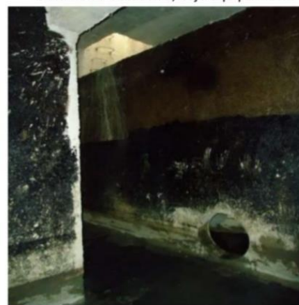
Figura 2.27. Sistema de detención en San Martin. [Fuentes: COAMSS/ OPAMSS.]
