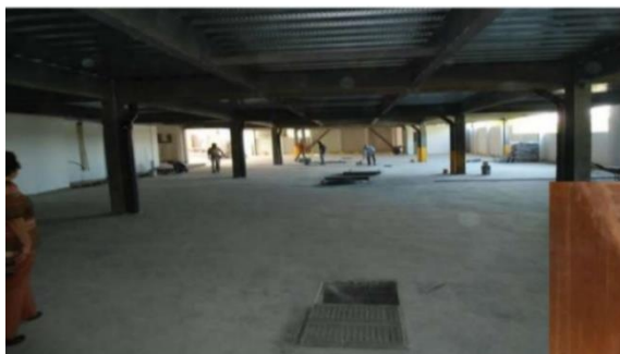
Cisterna de detención, con sistema de bombeo
