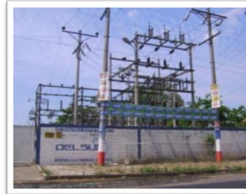
Imagen 18. Subestación de DELSUR en San Marcelino.
