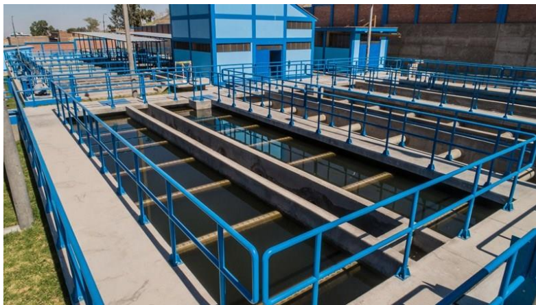
Ilustración 34. Planta de tratamiento de aguas residuales.
