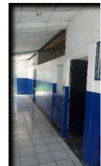
Figura 131. Acceso existente de zona administrativa visto desde el exterior e interior. Fuente: Elaboración propia.
