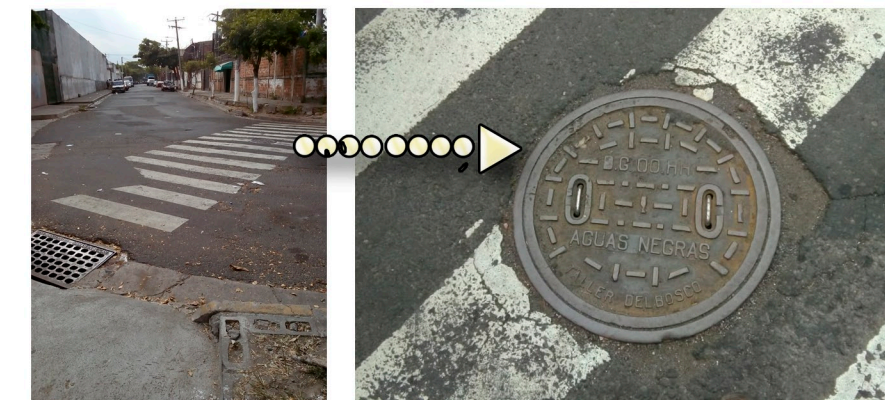
Fig. 80 y 81. Localización de pozo de aguas negras en intersección Calle Campos y Avenida Barberena. Fuente: Elaboración propia
