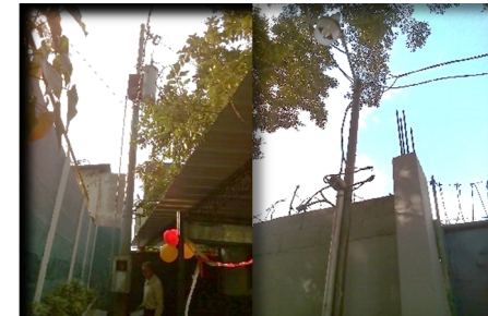
Figura 122. El INCO posee el suministro de energía eléctrica mediante una empresa distribuidora.
