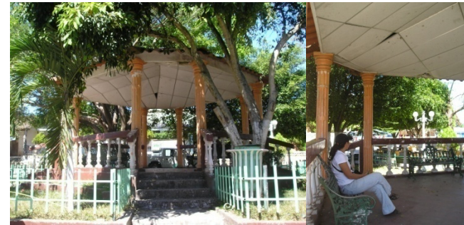
Foto5 y 6: Estado actual de glorieta del parque.
