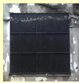
Se han colocado estructuras metálicas en los huecos de puertas y ventanas que lindan a la calle.
