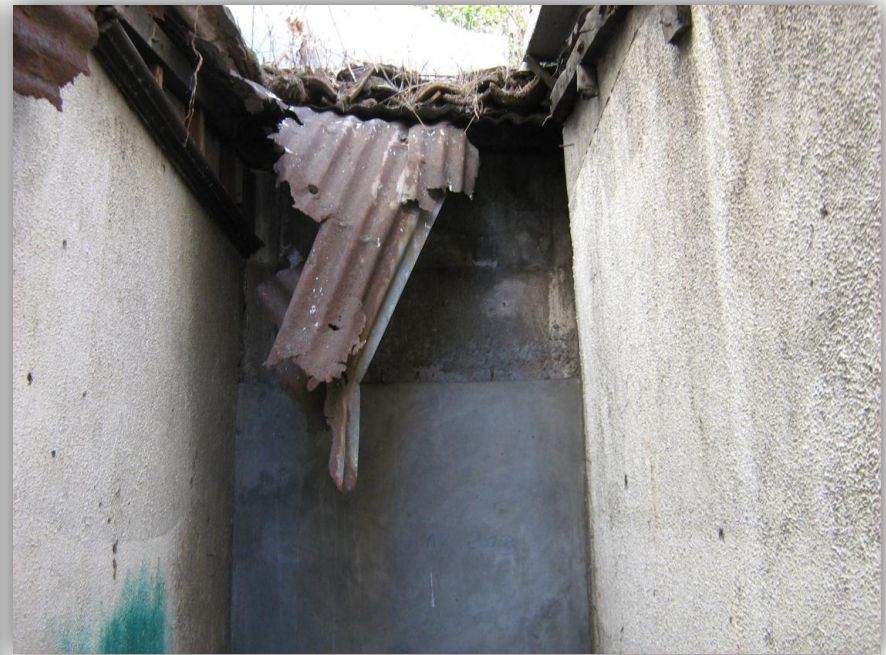
Estado actual del techo Foto N°13
