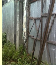
No poseen portón en las cocheras y se han colocado láminas para proteger su interior.
