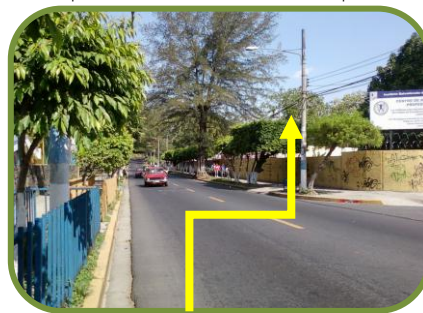
Foto N° 9. Luminarias de alumbrado público
