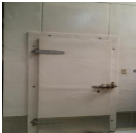
FIGURA 11: Puerta externa de cuarto frío
