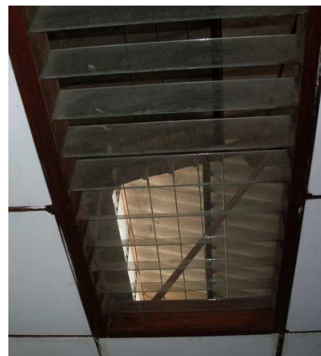
IMAGEN No. 6 Tragaluces del pasillos del área de técnicos con iluminación deficiente.
