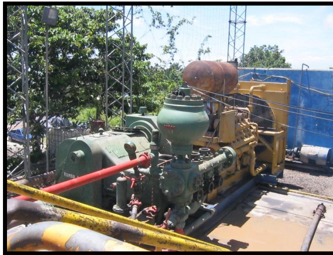
Figura 3.6 Bombas triples de lodo de perforación
