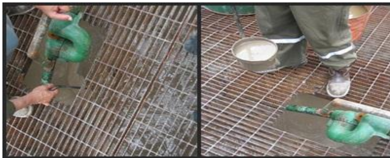
Figura 5.1 Recolección de muestras en presa de succión (Fotografía en el Equipo Massarenti 6000 en Berlín, Usulután cortesía de PSB)
