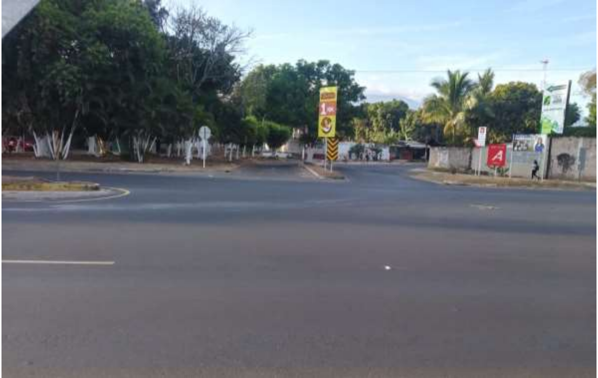
Fotografía 7: Estado Actual de Carretera By Pass entrada a Chalchuapa desde Santa Ana.
