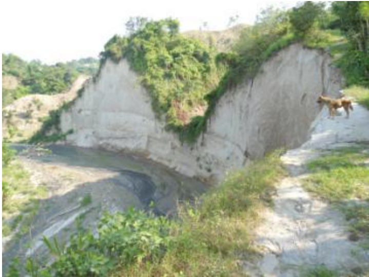
Imagen 37. Calle de acceso a Comunidad el Sauce 1, colapsada por avance de cárcava en río El Sauce
