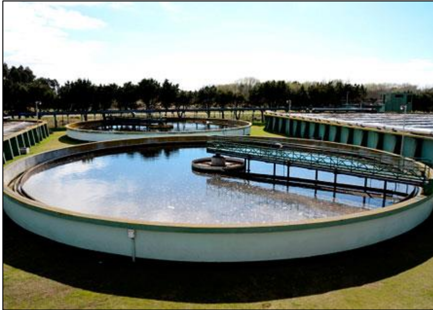
Ilustración 2-9 Tanque sedimentador fuente: Cooperativa de obras y servicios públicos de santa teresita LTDA. 6
