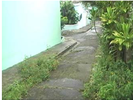
Pasaje peatonal inclinado con 19% de pendiente recubrimiento deteriorado
