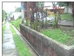
Jardinera de concreto estado de deterioro
