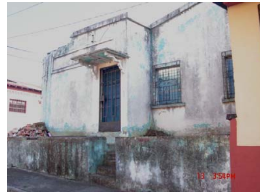
Fotografía tomada de vivienda abandonada, Col Las Delicias, abril 2008
