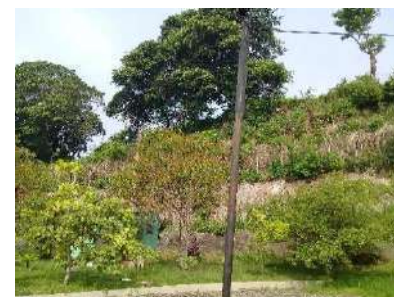
Foto 12. Vista de talud en terreno final calle la Gloria. Fuente: visita de campo 11/05/2018
