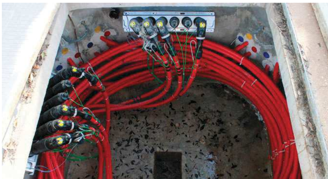
Ilustración 123: Ejemplo de un pozo eléctrico con dos derivadores instalados.
