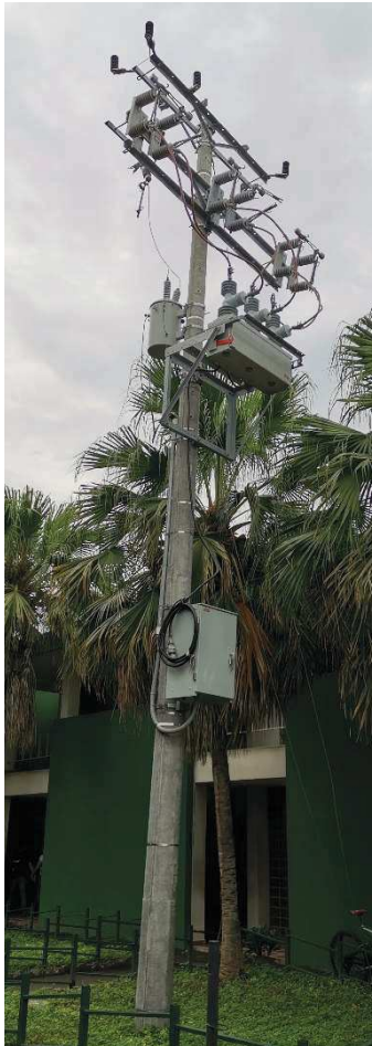
Ilustración 125: Recloser y poste instalado actualmente no utilizado, el cual está contemplado en el diseño para bajar la acometida.
