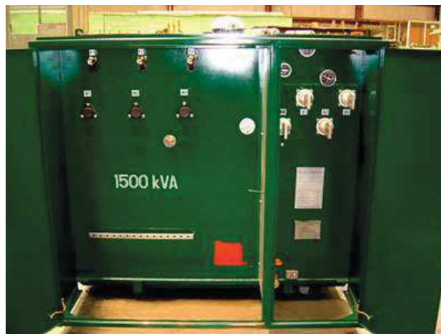
Ilustración 103: Transformador tipo pedestal para configuración radial.
