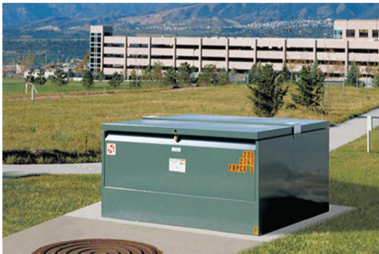
Ilustración 100: Imagen de un transformador tipo pedestal de una acometida subterránea.
