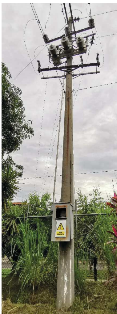
Ilustración 124: Poste donde se encuentra la medición de la acometida de agronomía actualmente.
