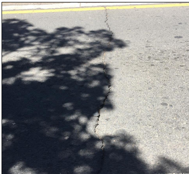
Figura 3.12 Fisuras transversales en el pavimento
