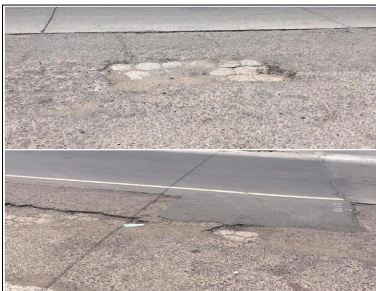
Figura 3.13 Desintegración por peladura en tratamiento asfáltico.
