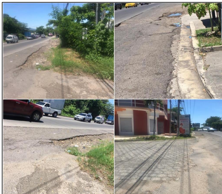
Figura 3.15 Agrietamiento en bordes severidad alta
