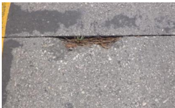
Figura 4.14 Despostillamiento de Junta.
