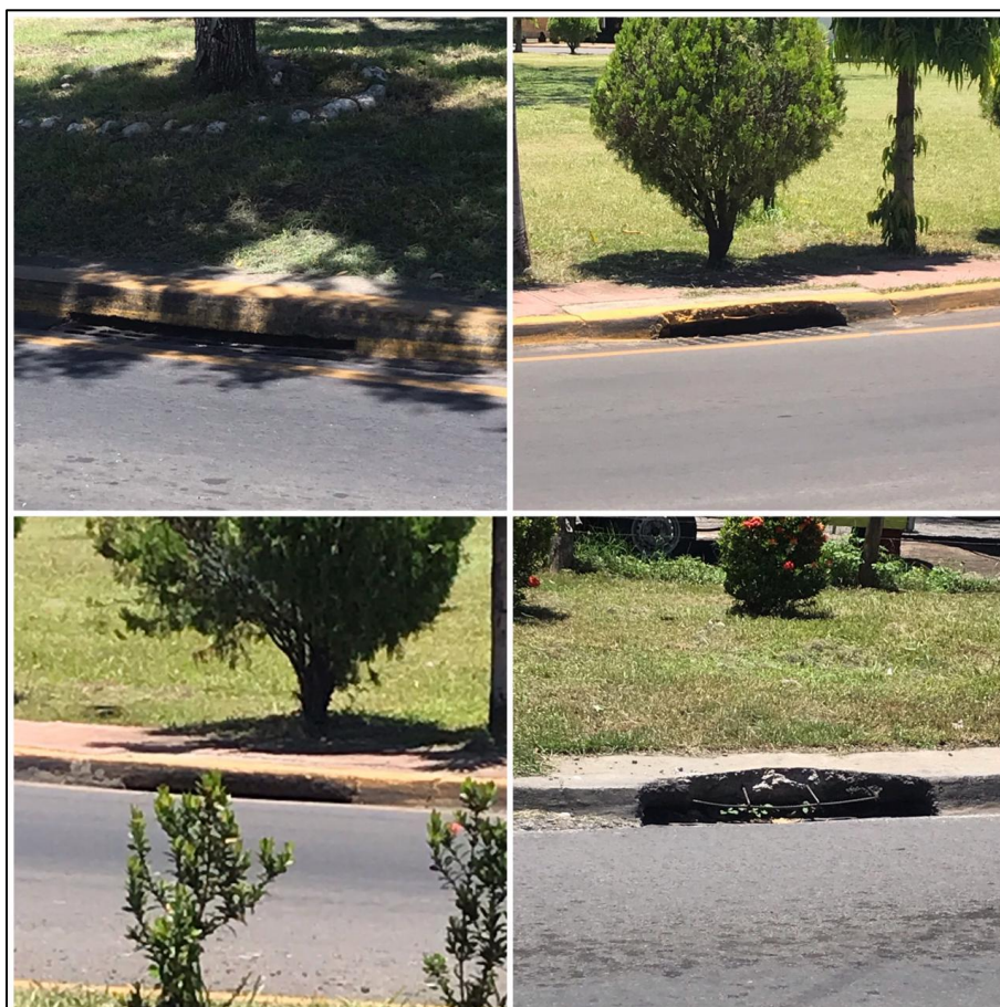
Figura 3.5 Tragantes existentes en la estructura del redondel
