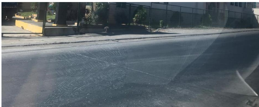
Figura 4.15 Deficiencias del sellado.
