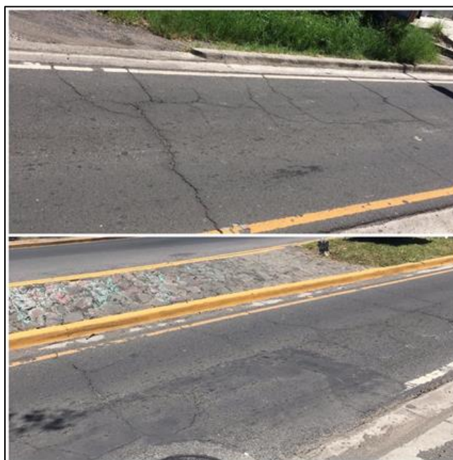
Figura 3.9 Fisuras en bloques de severidad media
