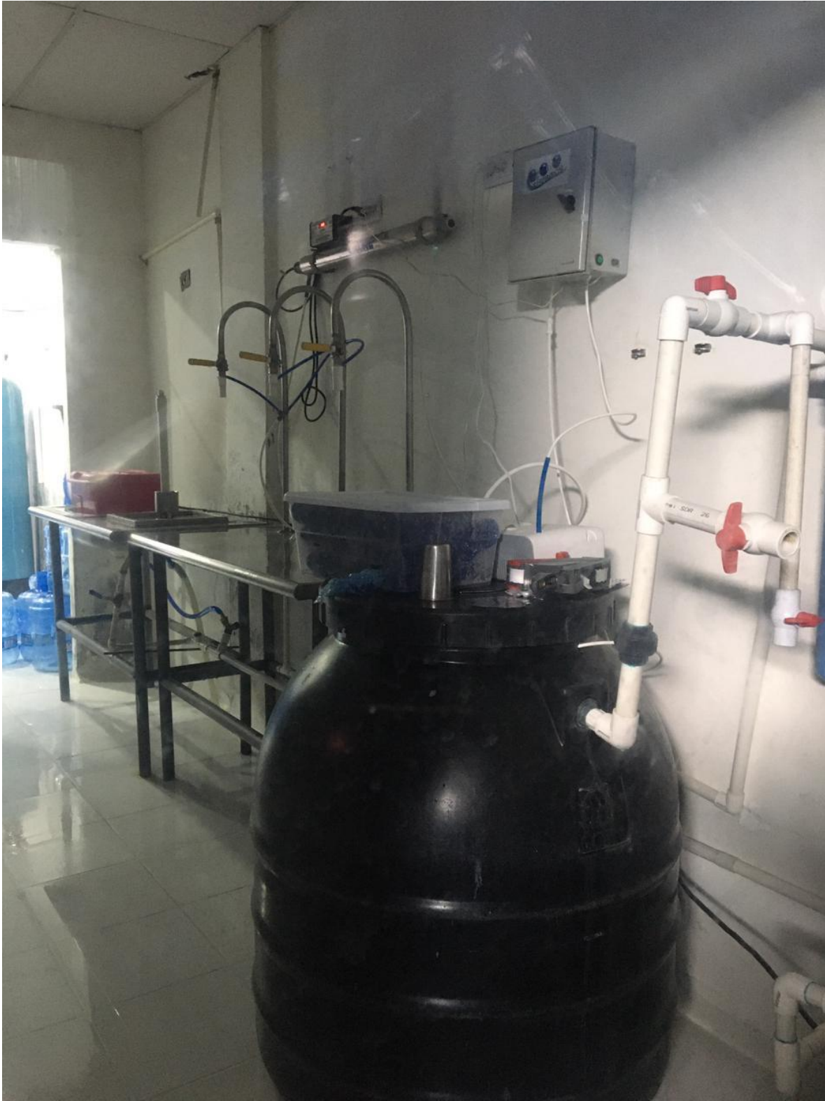
Figura 1: Área de filtrado de llenado de Garrafas
