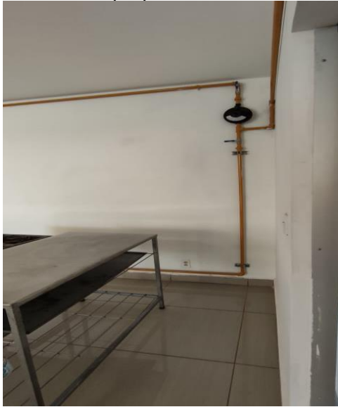
Fotografía N° 28. Mesa y tuberías de gas propano.
