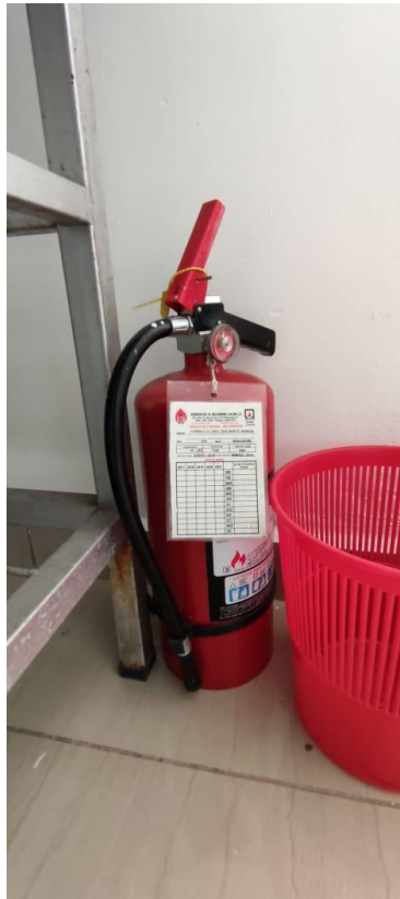
Fotografía N° 26. Extintor disponible en el área de cocinas.
