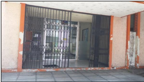
Fachada de la entrada principal de la imprenta, paredes deterioradas.
