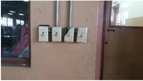
Equipo eléctrico en mal estado por falta de mantenimiento.
