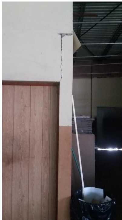
Paredes del área de producción con grietas.
