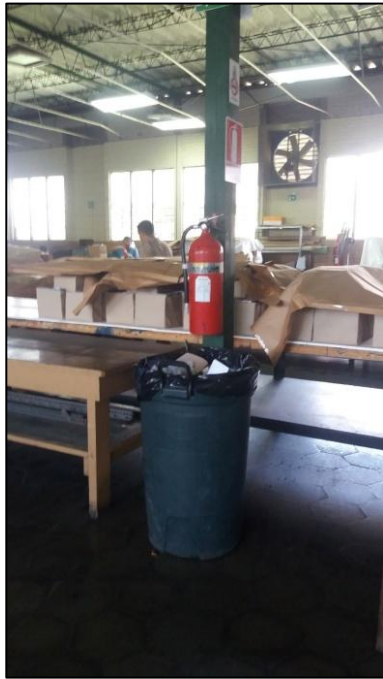
Extintores obstaculizados con basureros
