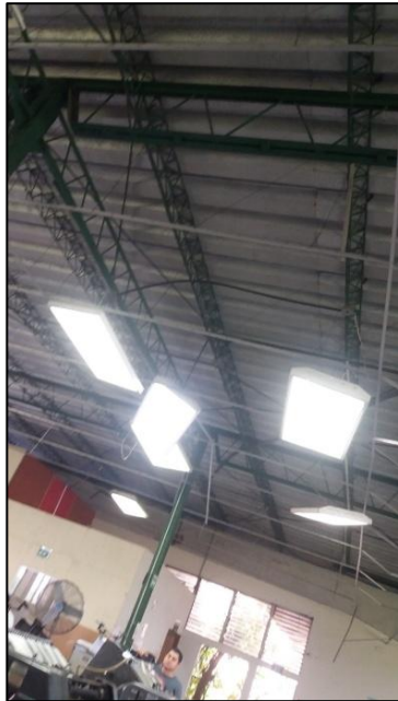
Lámparas suspendidas en el área de producción debido a la falta de cielo falso
