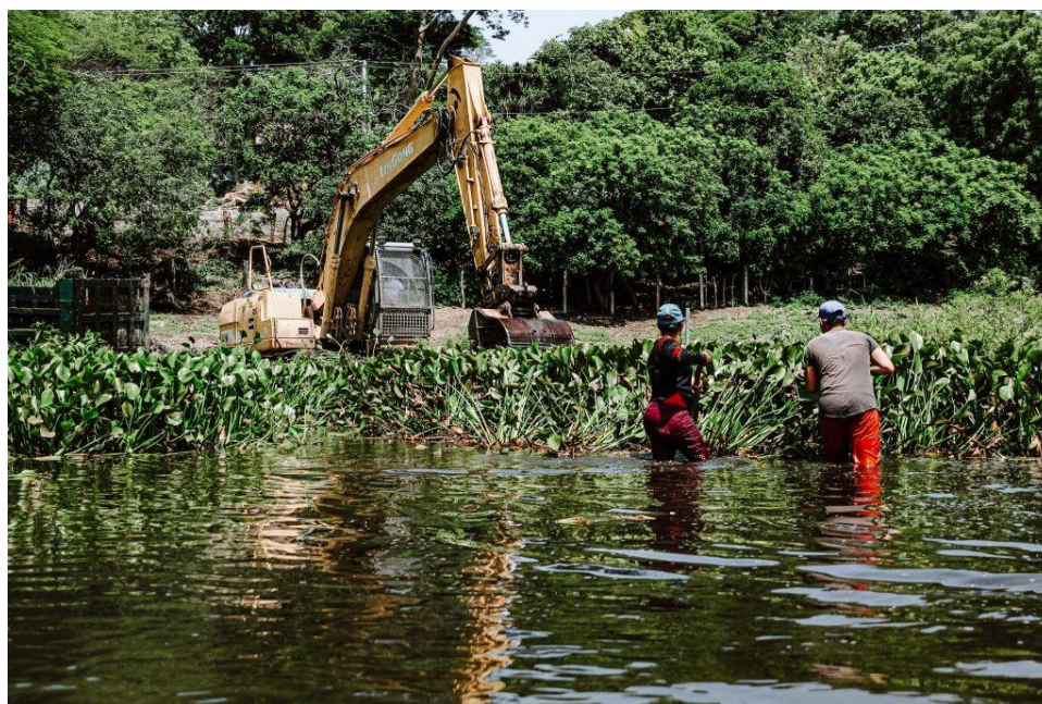
Figura 4-1. Extracción del Jacinto de Agua en Laguna de Metapán. Fuente: MARN, El Salvador (2021).
