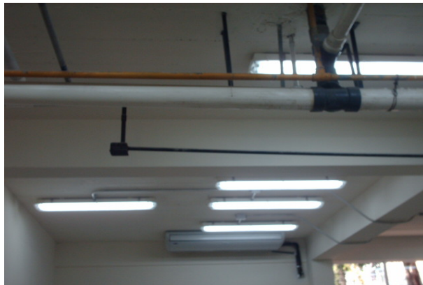
Sistema de aire acondicionado e iluminación del área de producción.
