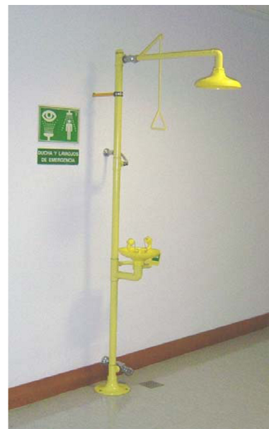
Figura N° 24 Ducha de emergencia
