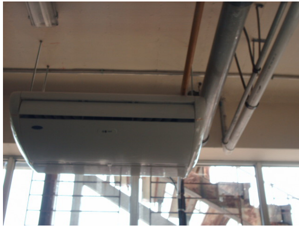
Sistema de aire acondicionado de la zona.
