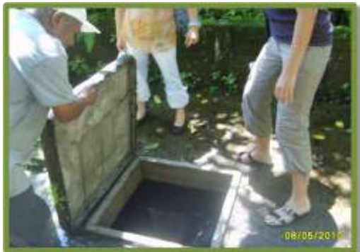
TANQUE DE RECOLECCION DE AGUA
