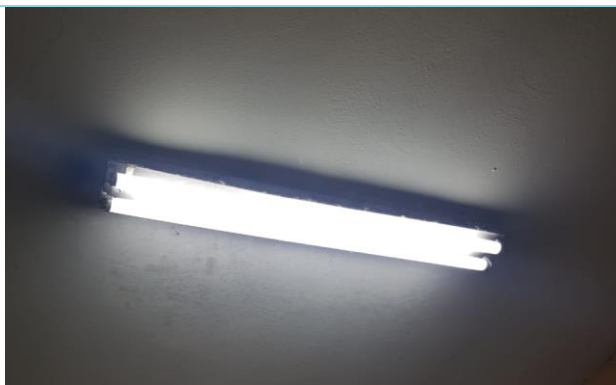
Foto 8. Descripción tipo de iluminación artificial. La oficina de la dirección cuenta con tipo de iluminación natural e iluminación artificial con lámparas fluorescentes.
