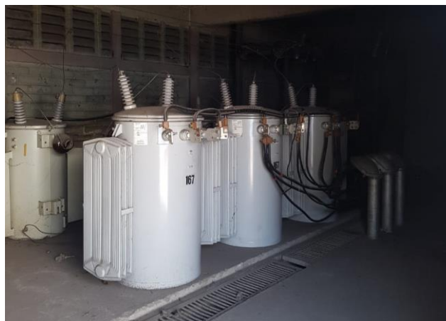
Ilustración 33 Subestación de 167 KVA
