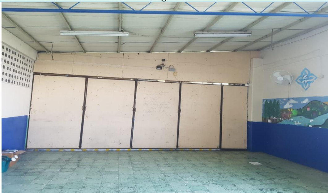
Foto 2. Descripción tipo de iluminación artificial. Los salones de clases cuentan con tipo de iluminación natural e iluminación artificial con lámparas fluorescentes.
