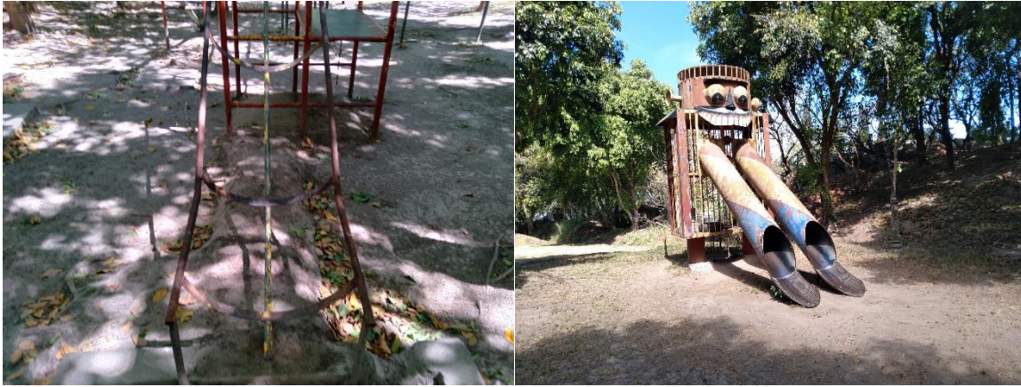
Figura 36 Deterioro de juegos para niños
