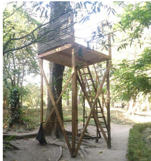
Figura 17 Estado de una estructura de canopy
