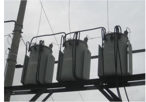
Figura 4-1. Banco de transformadores monofásicos. Tomado de: (Rodríguez, 2016).
