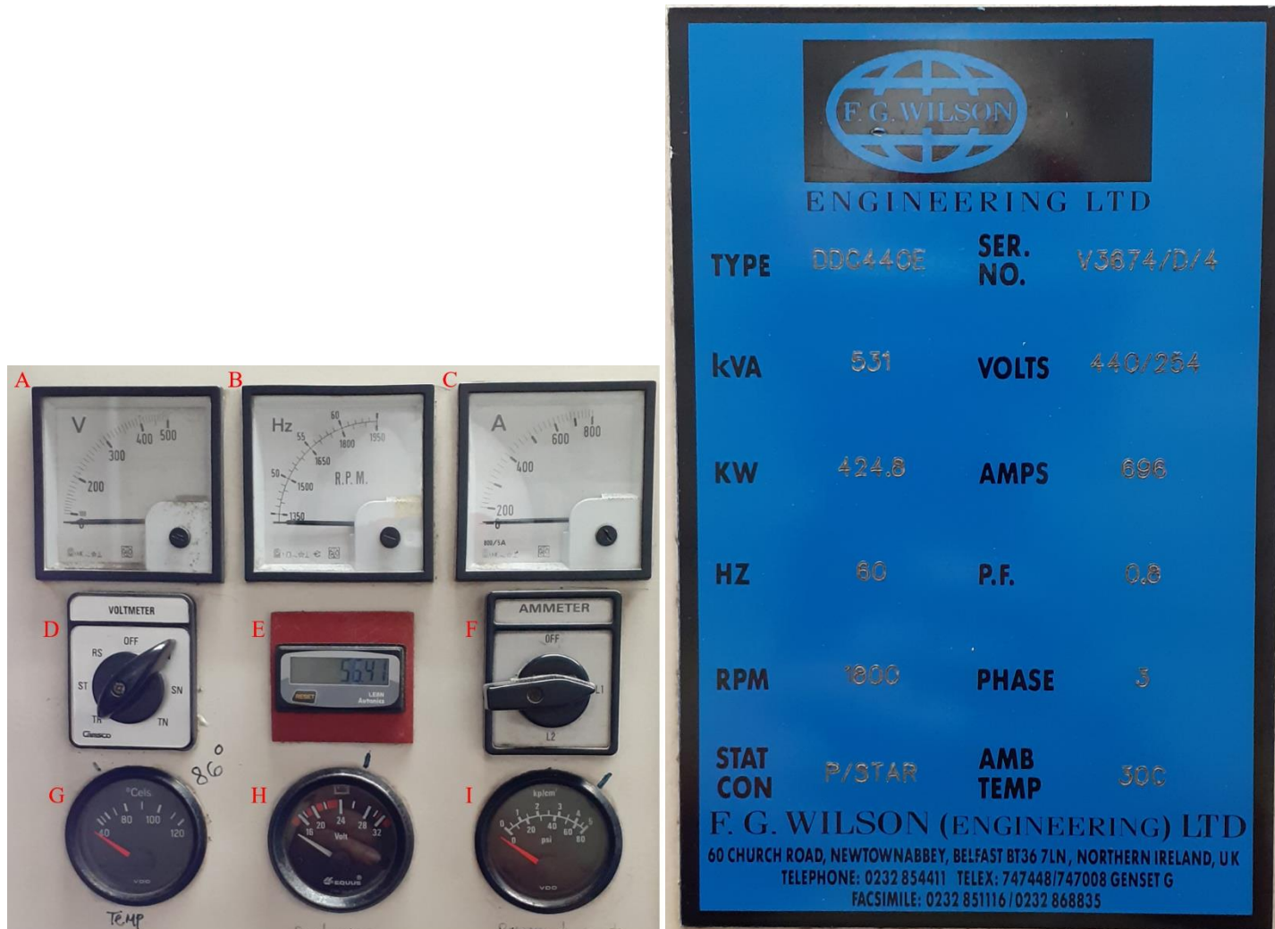
a) tablero de mando y control b) datos de placa.
