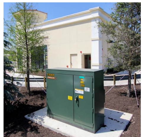
Figura 4- 14. Transformador trifásico tipo Pad Mounted. Tomado de: (PROLEC, 2020).
