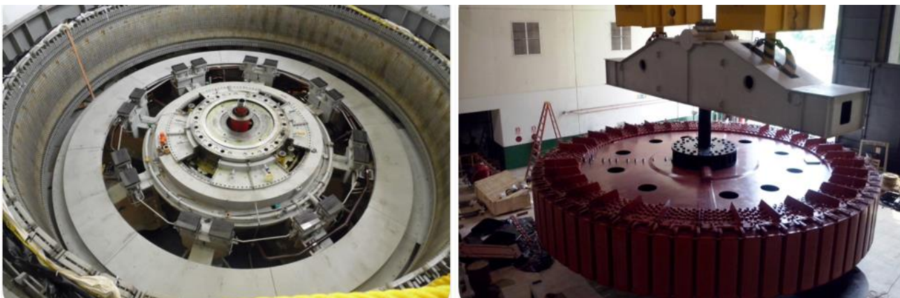
Figura 4.1: Generador U1, central hidroeléctrica 15 de septiembre.
