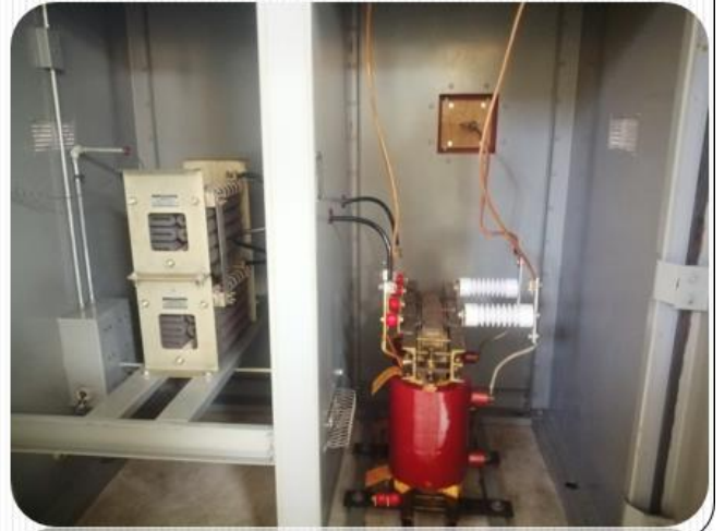
TRAFO MONOFASICO DE ALTA IMPEDANCIA DE PUESTA A TIERRA
