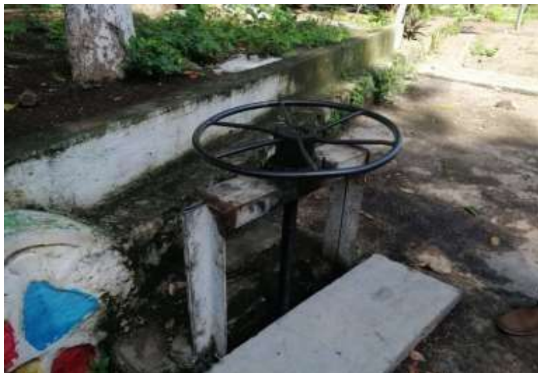
Imagen 47 Sistema para el mantenimiento de la Piscina (compuerta manual)
