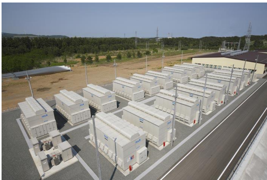
Figura 42: Instalación de baterías NaS de 34 MW, 245 MWh [37].
