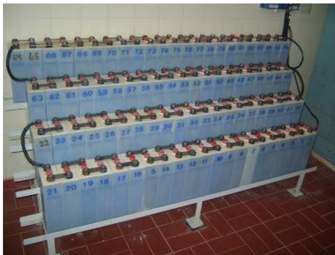
Figura 29: Banco de baterías [29].
