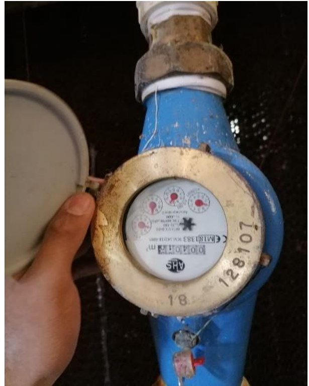
Img. N° 18. Medidor de niveles de agua.
