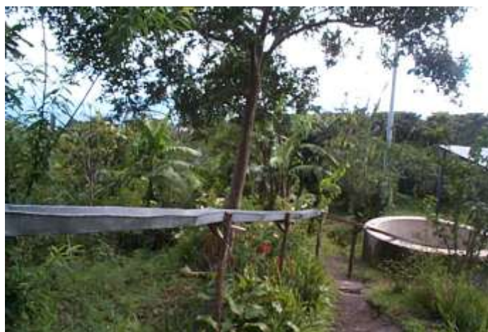
FIG 3.6 RECEPCIÓN DE AGUA LLUVIA EN UN TANQUE DE ALMACENAMIENTO.
