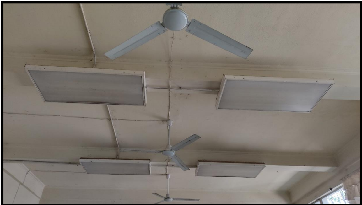
Figura IV-64 “Ventiladores y lámparas de techo ubicadas dentro de las aulas del Edificio C del C.E. INSA”
