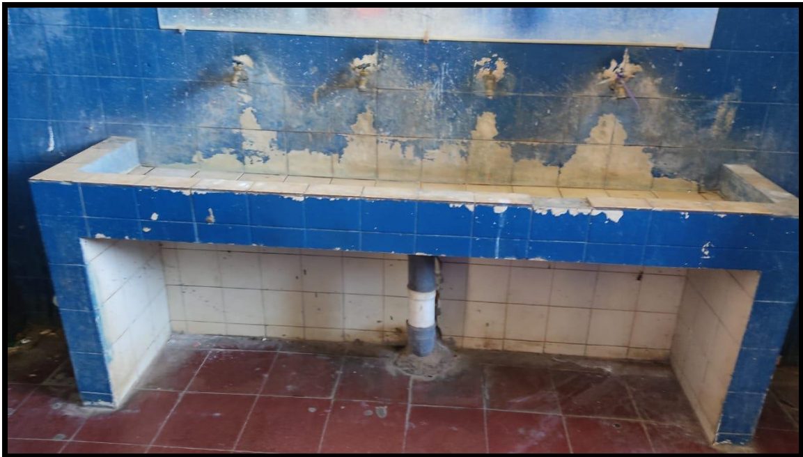
Figura IV-63 “Lavamanos de concreto en área de servicios sanitarios del Edificio C del C.E. INSA”
