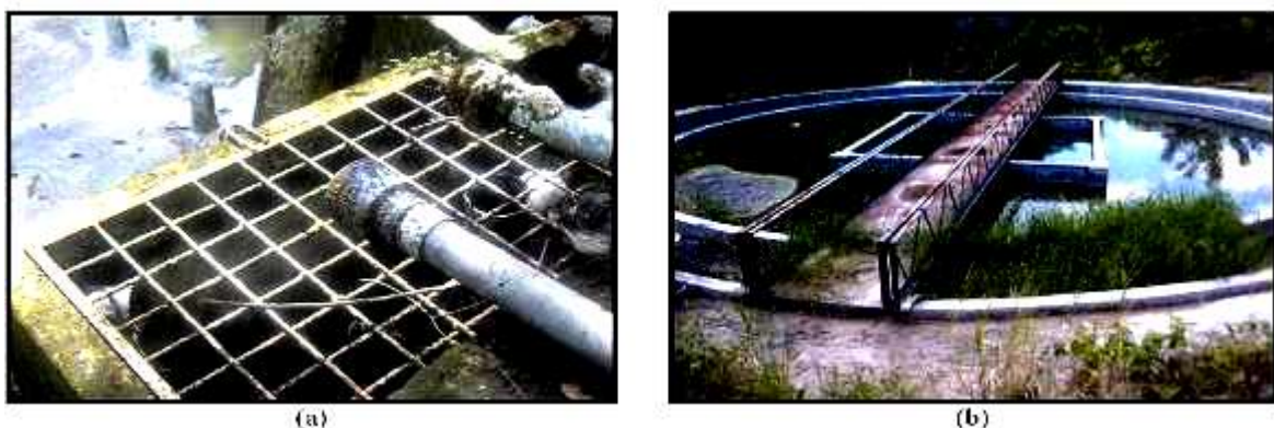
Figura 5.59 Sistemas de Tratamientos con Daños. (a) Tuberías Oxidadas. (b) Pasarela en Sedimentador Deteriorada.
