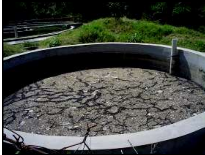
Figura 4.4 PTAR Urbanización Vista al Lago, Patio de Secado de Lodos (Fuente Propia: Barrera, Héctor y Ramos, Dalia).
