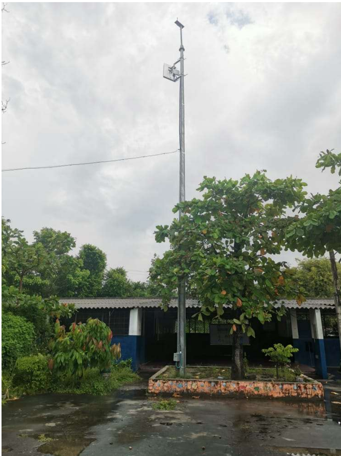
Antena externa para la captación de señal de internet satelital, fotografía tomada en la visita al Centro Escolar Morelia el 27 de agosto de 2021
