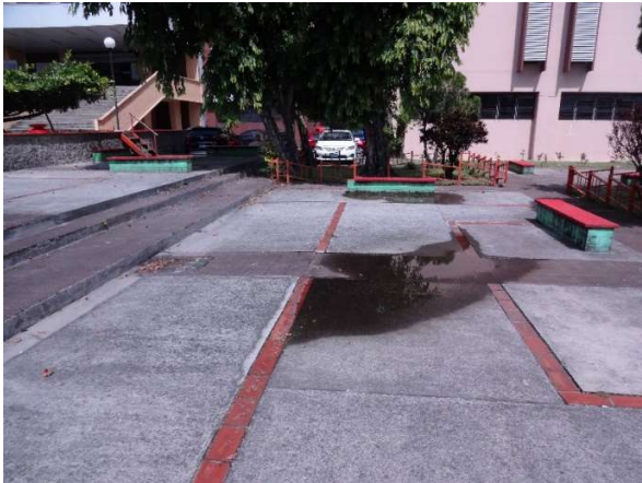
Imagen 31: Charcos de agua formados en la plaza del edificio de Medicina.
