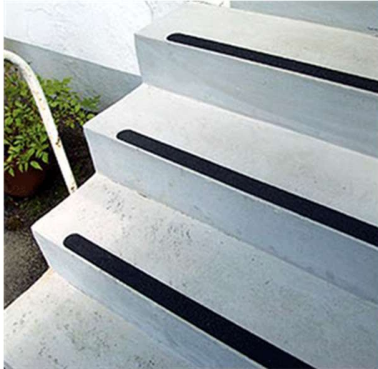
Imagen 164: Ejemplo de escalera con cinta antideslizante.
