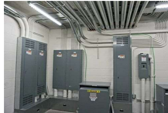
Imagen 166: Ejemplo de cuarto eléctrico.
