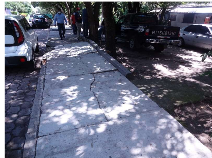
Imagen 26: Aceras agrietadas y levantadas a consecuencia de las raíces de los árboles.
