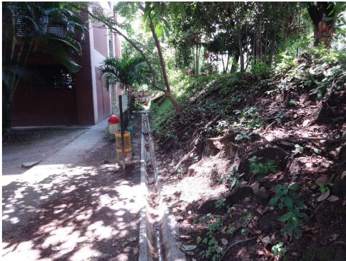
Imagen 27: Taludes erosionados falta de mantenimiento en los alrededores del edificio de Medicina.
