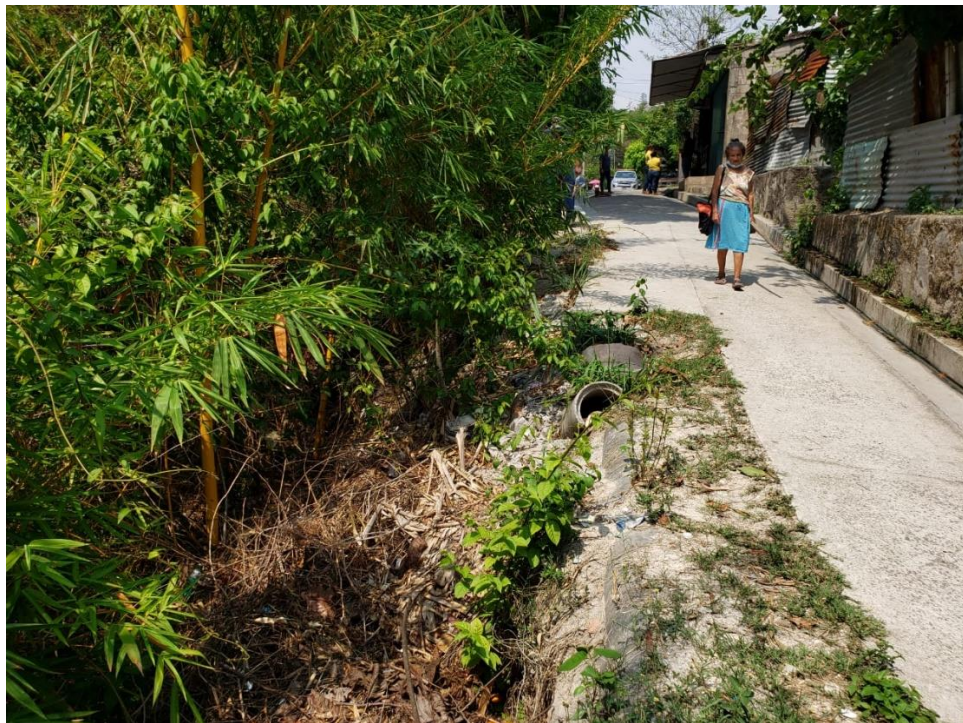
Fotografía 3.2. Tramo de la calle afectada por la erosión (abril, 2021).
