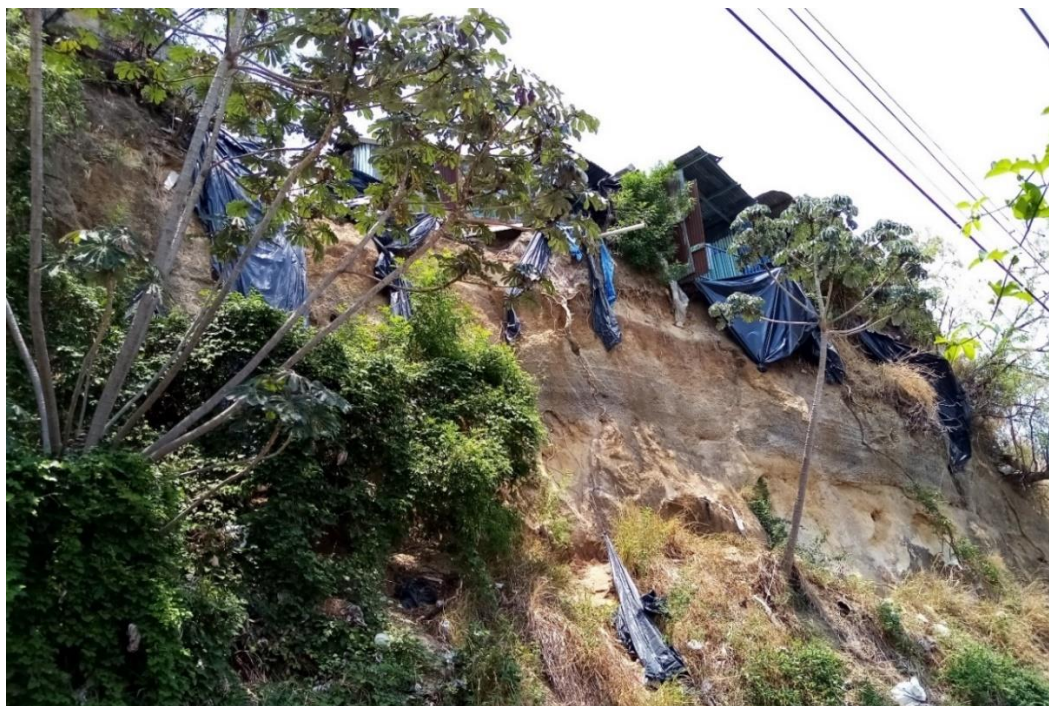
Fotografía 4.1. Viviendas existentes al borde de la corona del talud (abril, 2021).
