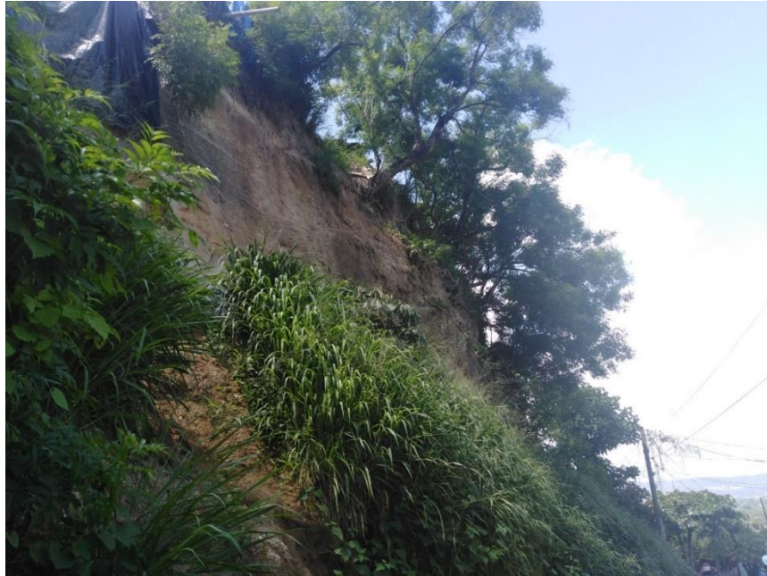
Fotografía 4.2. Fotografía del talud tomada en el 2019 (DACGER, 2019).
