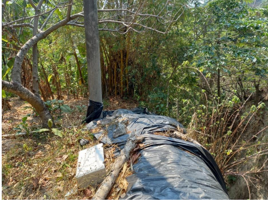
Fotografía 4.6. Poste de tendido eléctrico al borde de la cárcava (abril, 2021).
