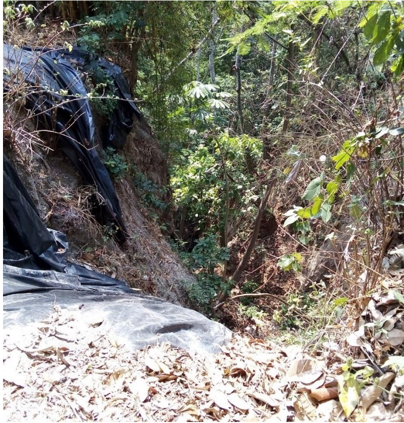
Fotografía 4.5. Cárcava que se ha generado sobre el terreno (abril, 2021).
