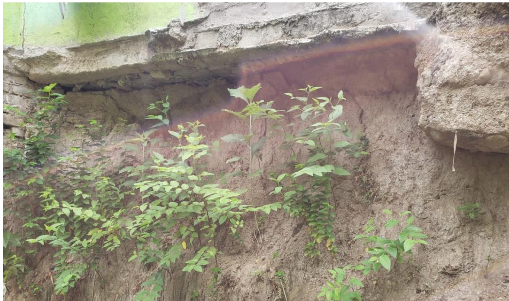
Fotografía 3.11. Suelo existente por debajo de vivienda, el cual consiste en arena limosa, altamente susceptible a erosión hídrica (abril, 2021).
