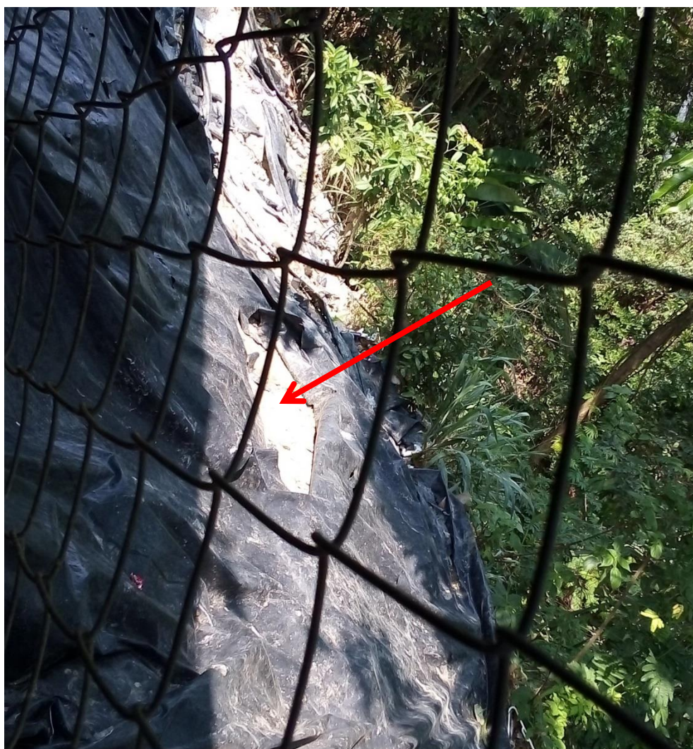
Fotografía 3.8. Vista de los daños presentes en el talud, desde el interior de una de las casas que está al borde de la ladera (abril, 2021).
