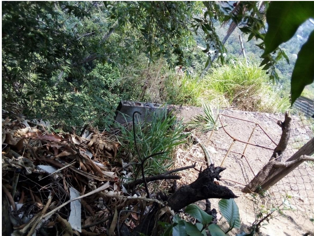
Fotografía 4.4. Parte del muro de retención que aún se mantiene en pie (abril, 2021).
