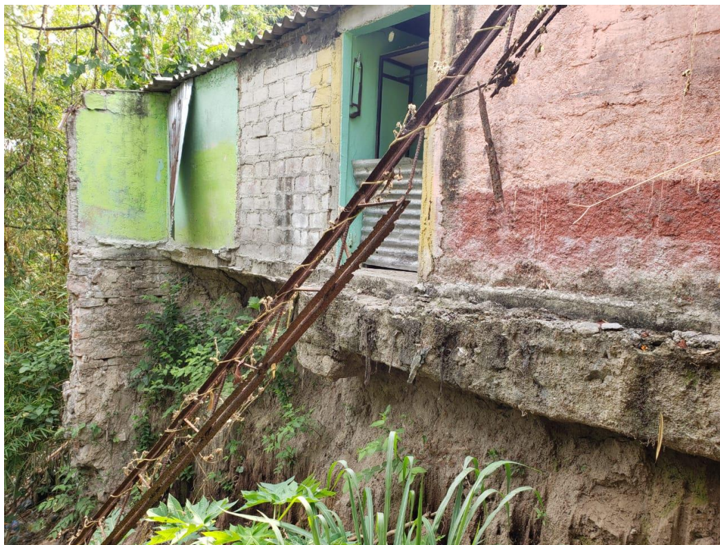
Fotografía 3.9. Socavación del suelo donde esta cimentada la casa (abril, 2021).
