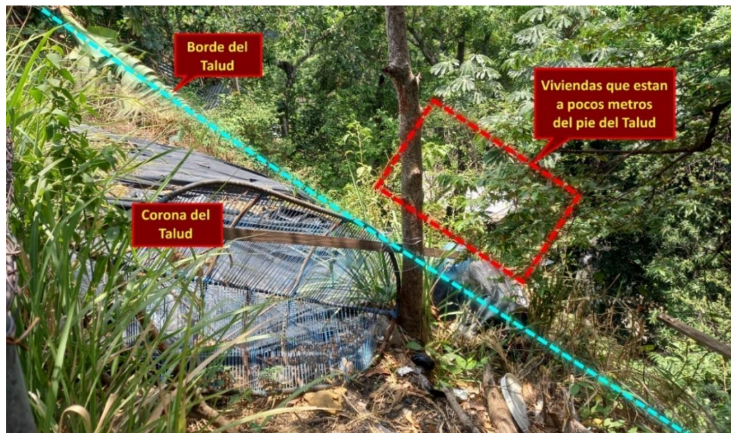
Figura 4.6. Viviendas que están cerca del pie del talud (septiembre, 2021).
