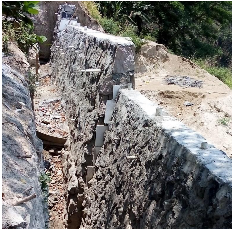
Fotografía 4.10. Muro de retención en construcción por parte de la Alcaldía Municipal (abril, 2021).
