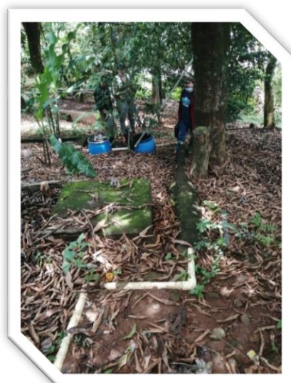
Figura 10: Estructura observada para el tratamiento de aguas grises. 2021.
