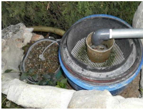
Figura: 2 Tecnología de tratamiento de aguas grises en Nicaragua.
