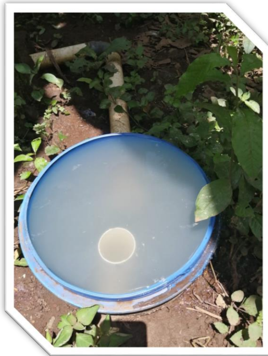
Anexo A2. Trampa de grasa del sistema de tratamiento de aguas grises
