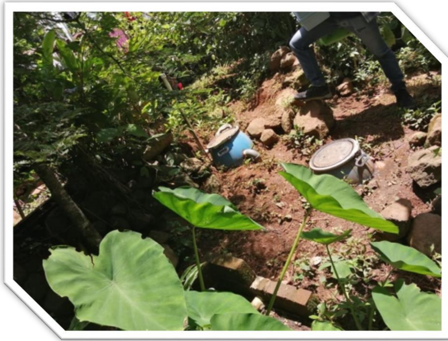
Anexo A1. Identificación de trampas de grasa del sistema de tratamiento de aguas residuales
