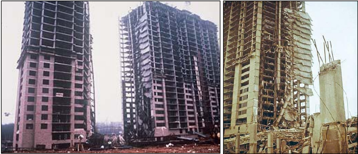
Figura. 2.14 Colapso de un segmento del edificio debido al retiro prematuro del encofrado.
