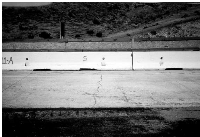
Figura 1.1 Efectos del sobredimensionamiento de juntas Fuente: Distress identification manual
