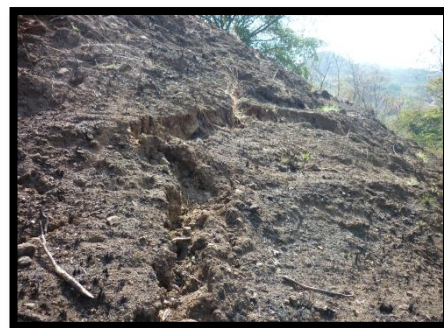
Figura 4.21 Grietas parte del escarpe principal.
