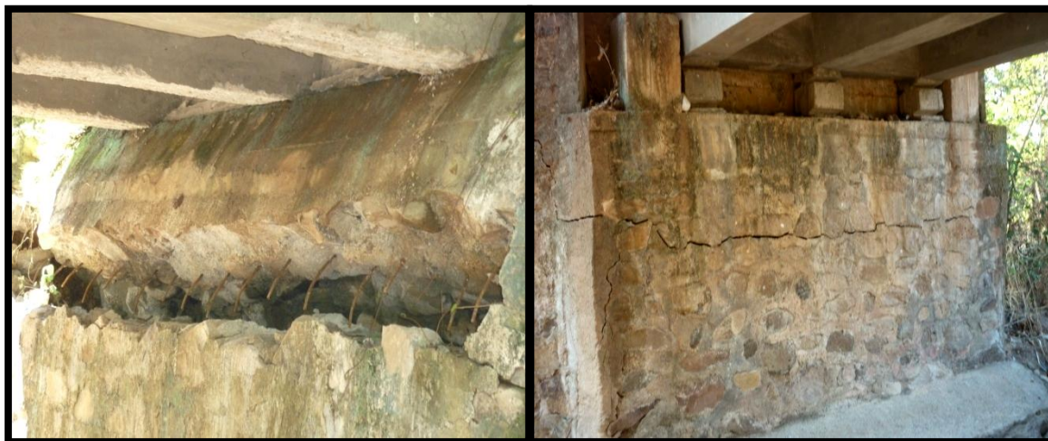
Figura 4.13 Daños en la infraestructura del puente.
