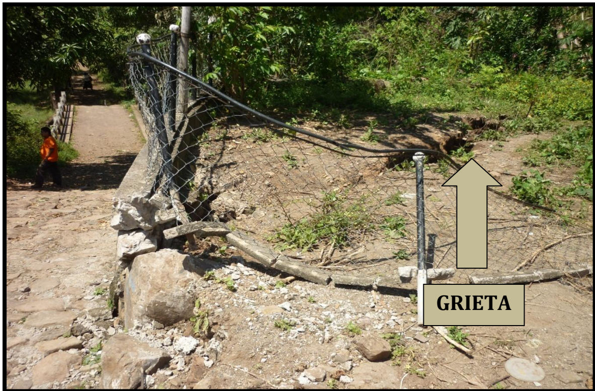
Figura 4.9 Grieta que ha dañado infraestructura.
