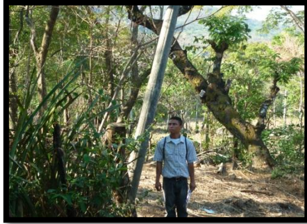
Figura 4.22 Inclinación de postes de luz.
