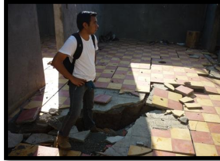
Figura 4.23 Piso dañado de una casa.
