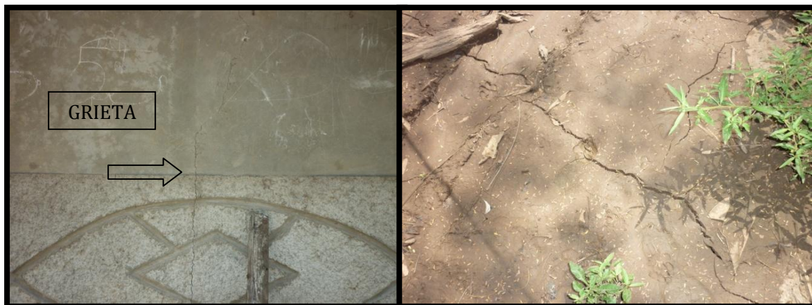
Figura 4.5 Grietas en la pared de una casa y pequeña que se está comenzando a desarrollar.
