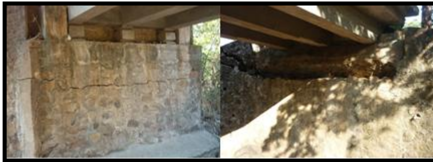
Figura 4.24 Puente dañado por deslizamiento.
