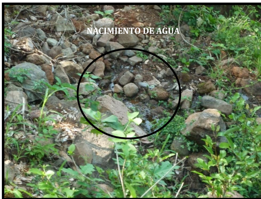
Figura 4.10 Nacimiento de agua ubicado en la zona inestable.
