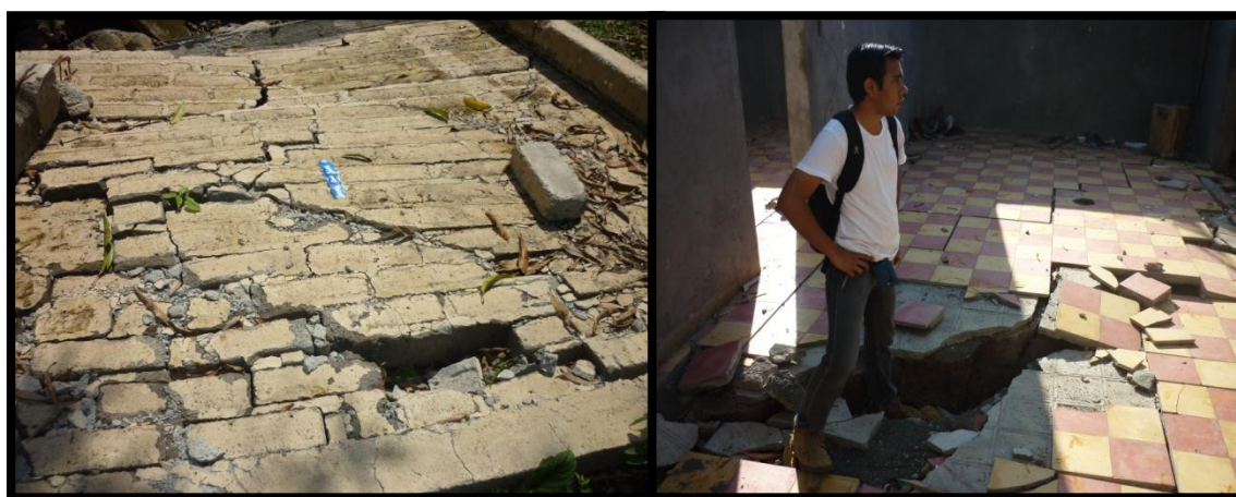
Figura 4.3 Pared derrumbada y grietas en el piso de una casa.
