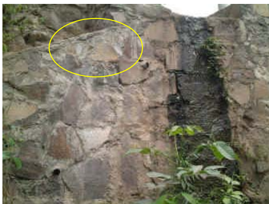
IMAGEN N° 10 Muro de alas con presencia de humedad y fisuras en el mortero
