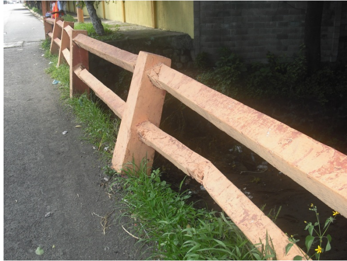
IMAGEN N°17 Daños en los barandales de concreto del puente El triangulo
