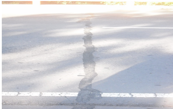
IMAGEN N° 25 de grieta transversal pte. El Jute
