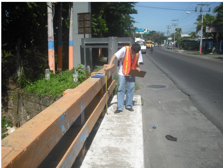
IMAGEN N° 14 Barandales de puente Ochoa
