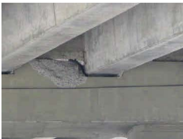
IMAGEN N°7 (Muestra pérdida de material en estructura de puentes)
