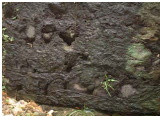
IMAGEN N° 13 Muro de alas con presencia
