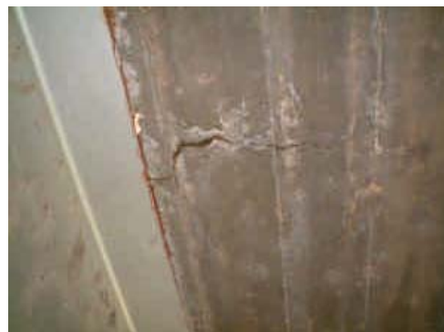
IMAGEN N°6 Grieta bajo losas
