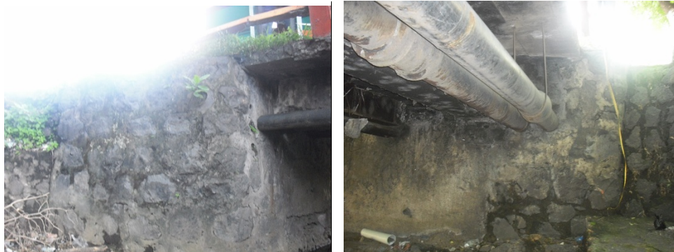
Humedad aletón salida izquierdo
