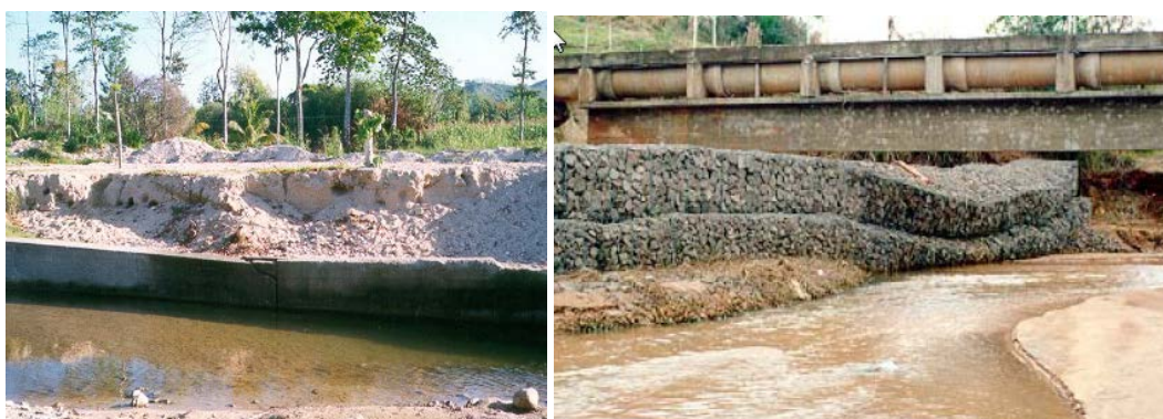
Imagen N° 30 Muro rigido dañado por asentamientos y borda de gaviones absorbiendo deformacion
