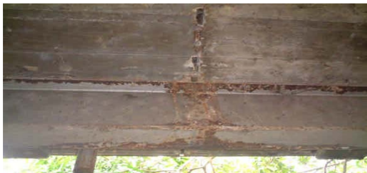
IMAGEN N°9 Elementos de puentes en evidente estado de corrosión
