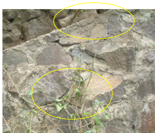
IMAGEN N° 11 Muro de mampostería con presencia de degradación en el mortero
