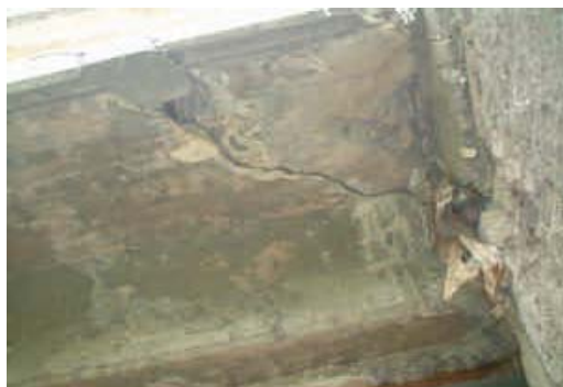
IMAGEN N°5 Grieta por cortante bajo la losa
