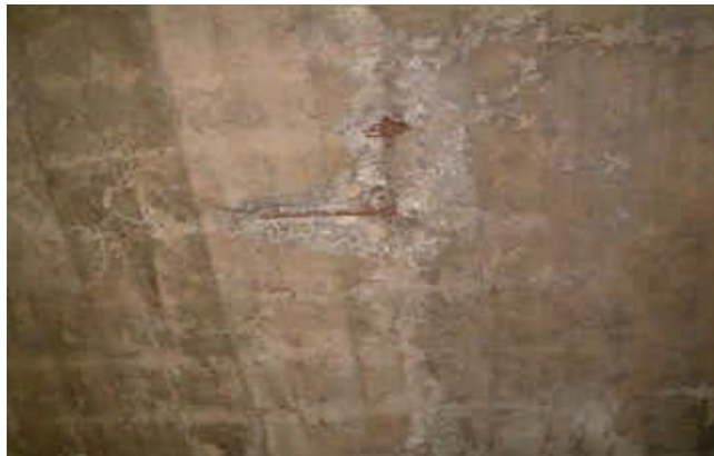
IMAGEN N°8: Acero Expuesto bajo la losa.
