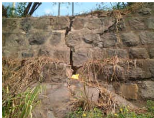
IMAGEN N° 12 muro con presencia de
