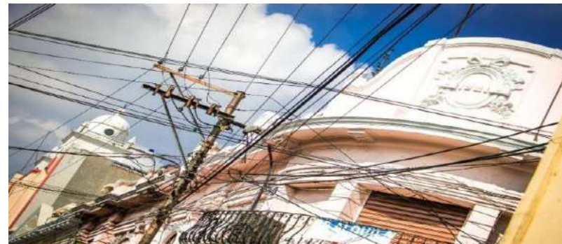
Imagen 62: Tendido Telefónico e Internet Fuente: Elaboración propia
