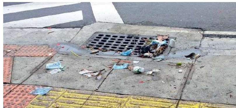
Imagen 59: Tragante Agua Lluvia Fuente: Elaboración propia
