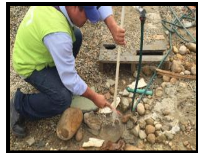
Figura 6, Conexión provisional de agua potable, fuente: Google imágenes
