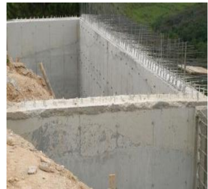
Figura 19 , Muro de concreto armado, fuente: Google imágenes.
