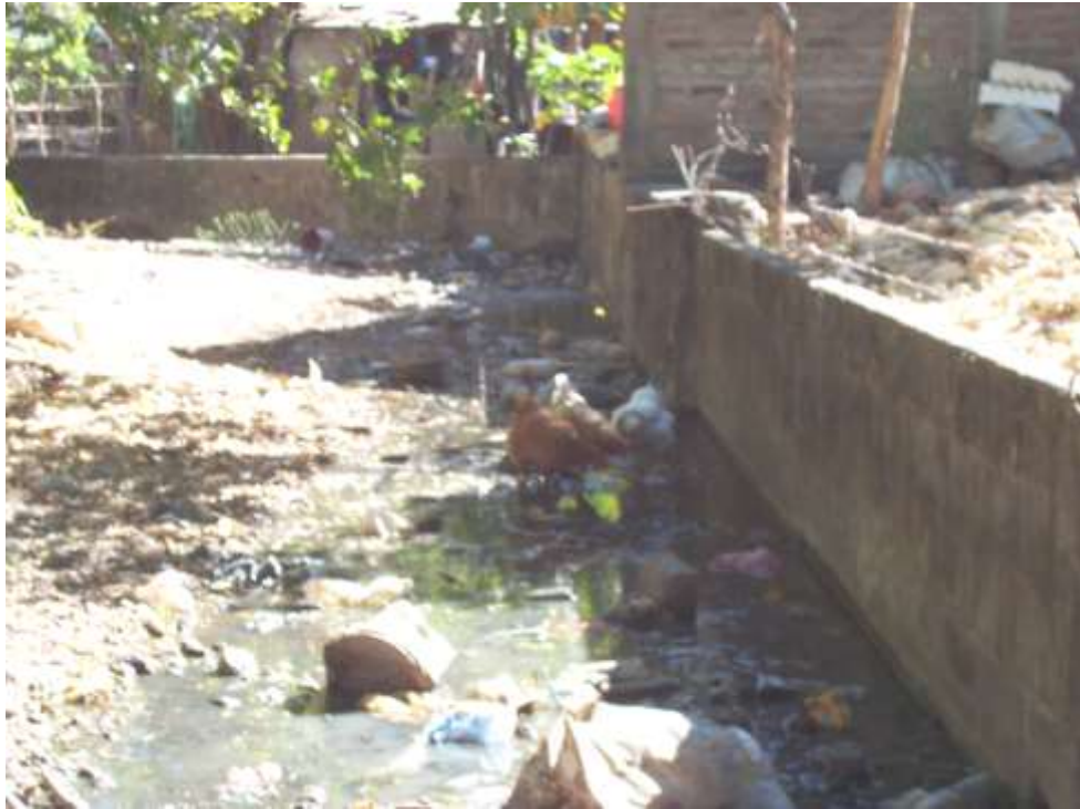
Fig.1 En la fotografía se muestra el Estancamiento de aguas de uso domestico en Quebrada la Esperanza de la Comunidad de Olomega.
