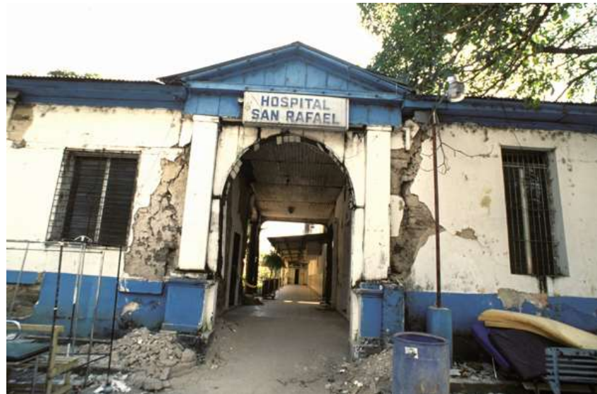
Figura 5.4 Daños en el hospital San Rafael/ fuente MSPAS
