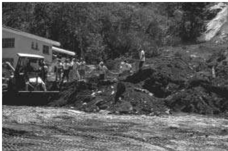
Figura 3.9 Generación de escombros después del terremoto de El Salvador, 13 de Enero de 2001.
