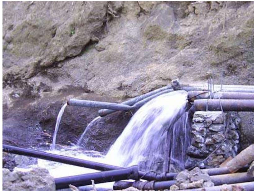
Figura 5.8 Daños provocados por la tormenta Stan en el sistema de agua potable/fuente ANDA
