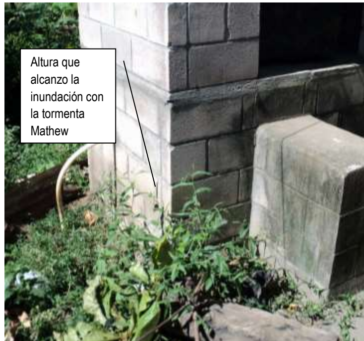
Figura 5.25 En la fotografía se puede observar la altura que alcanzo el agua y el daño que causa en las letrinas aboneras, ya que en el sector no se puede utilizar otro sistema de disposición de excretas.
