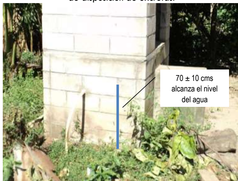
Figura 5.26 Mientras permanece la inundación estas letrinas no se pueden utilizar y a su vez representan un foco de contaminación para la comunidad
