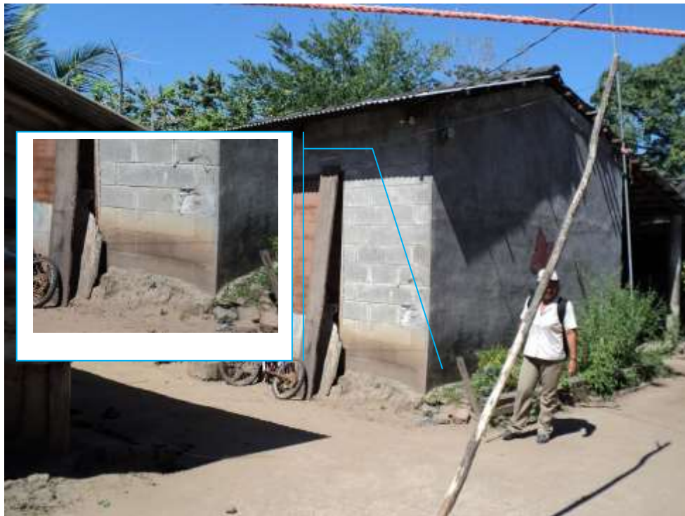
Figura 5.27 En esta fotografía claramente se puede apreciar las marcas que deja el nivel del agua el cual alcanza una altura considerable afectada a todas las familias de esta comunidad
