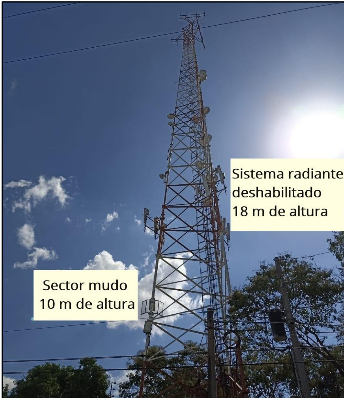
Figura 43: Antena de telecomunicaciones ubicada contiguo a centro penitenciario de Usulután, con antenas radiantes a baja altura y sector mudo instalado en estructura. (H. Torres, 2022).
