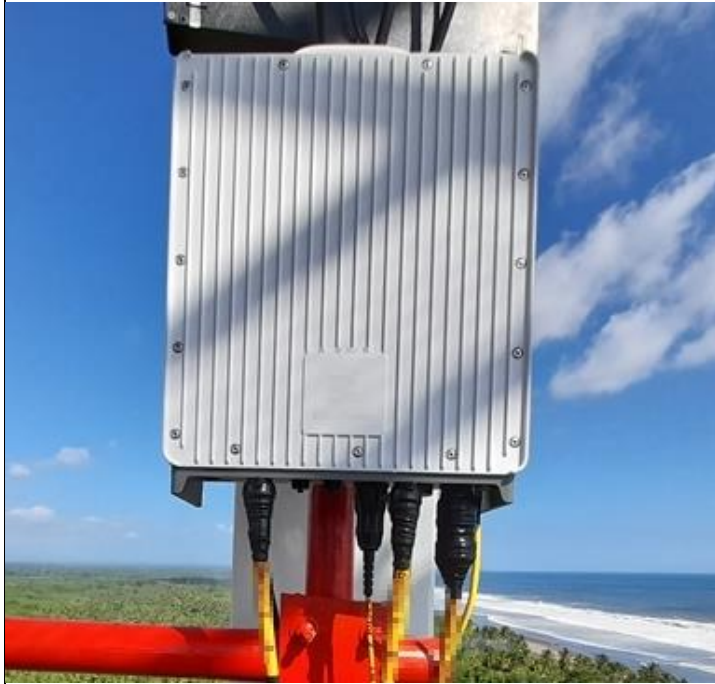
Figura 33: RRU utilizado en estaciones base. (H. Torres, 2022)
