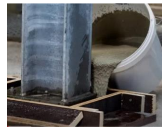
Imagen 17. Detalle de colado de grout autonivelante en columna metálica. Fuente: Grout epóxico. MC Baquemie Chile (Facebook)
