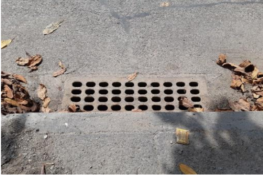
Figura 34. Caja tragante de aguas lluvias, al norte
