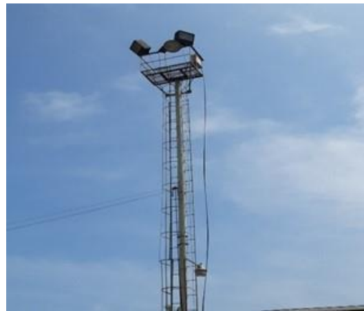
Figura 26. Elemento 4, luminaria en poste en el interior del patio Fuente: Elaboración propia
