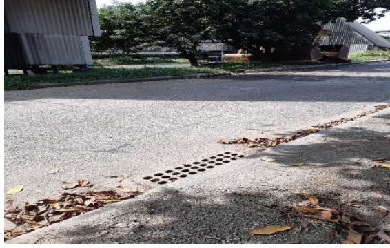
Figura 35. Caja tragante de aguas lluvias, al poniente
