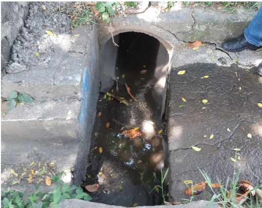
Figura 36. Caja y tubería \varnothing = 30'' colectora de ALL
