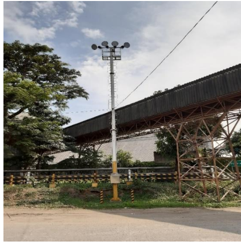
Figura 24. Elemento 3, luminaria led Fuente: Elaboración propia
