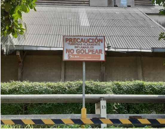
Figura 32. Tuberías de conducción de gas y gasolina Fuente: Elaboración propia
